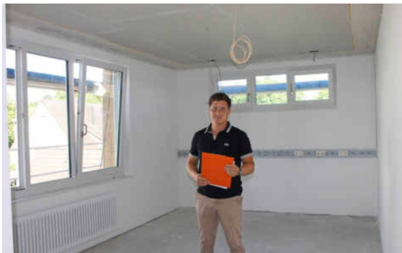
Ferdinand Böddinghaus im neuen Personalraum, um den das Gebäude erweitert wurde. Hier muss noch gestrichen und der Boden verlegt werden.
